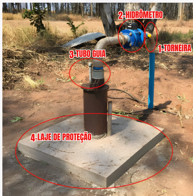
Figura 1: Foto de um poço com as adequações que a sema exige.
