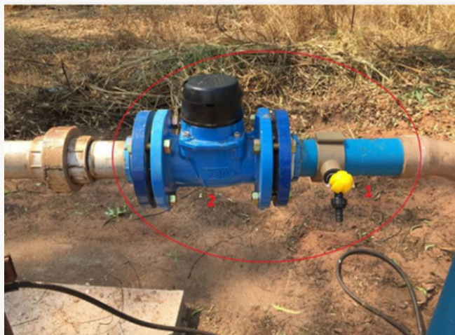
Figura 5: Foto em detalhe da instalação hidrômetro + torneira
