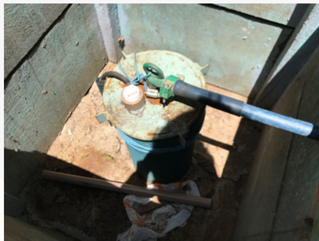
Figura 7: Foto de detalhe do tubo guia e da laje de proteção.
